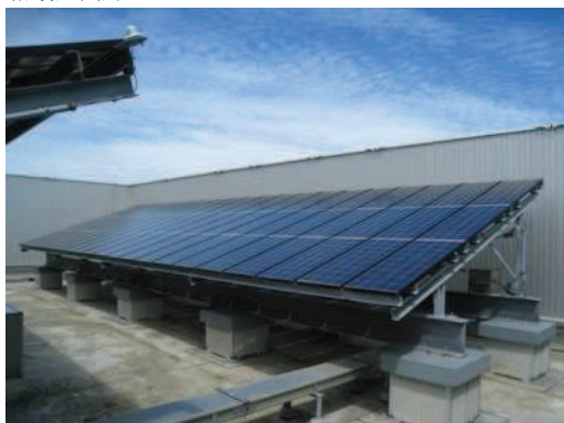
太陽光発電設備（防災センター屋上）
